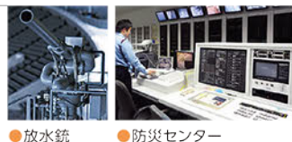
●放水銃 ●防災センター
