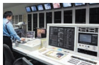
●防災センター
