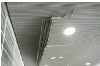
4階貴賓室天井ボードはがれ
